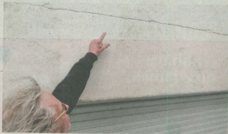
La façade fissurée d'une maison à La Tremblade, en novembre 2022. ARCHIVES PATRICE MERCIER / « SUD OUEST »
